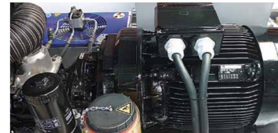
Der frequenzgesteuerte 30 kW Elektromotor
